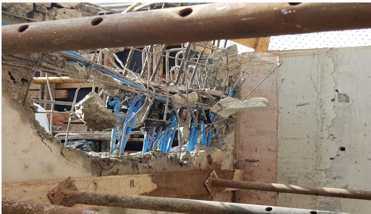
Figura 21 – Vista inferior lateral da situação da laje após rompimento da faixa de cabos não aderentes
