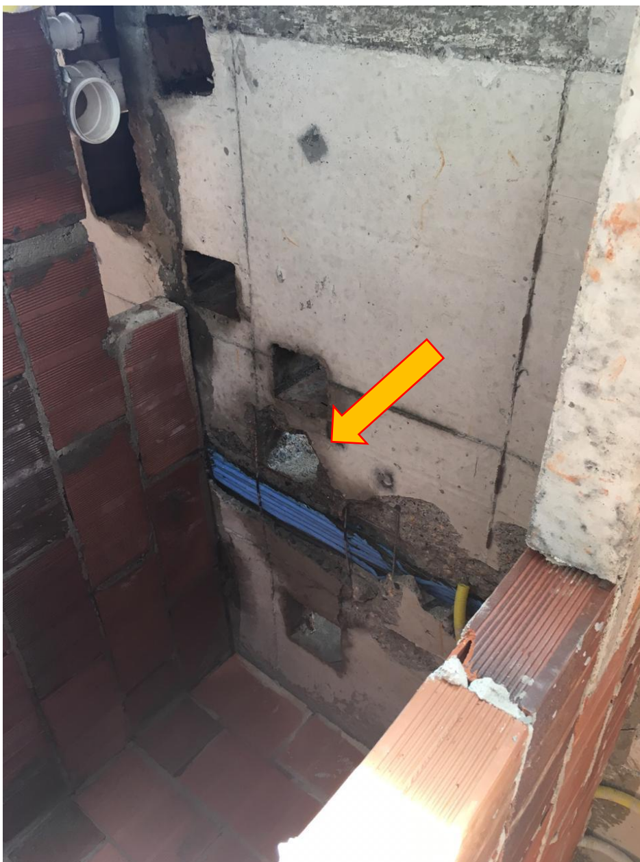
Figura 27 – Deslocamento de faixa de cabos próximo a caixas de passagens hidrossanitárias.
