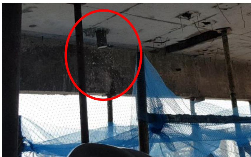
Figura 28 – Extração do corpo de prova em torno do sinistro ocorrido
