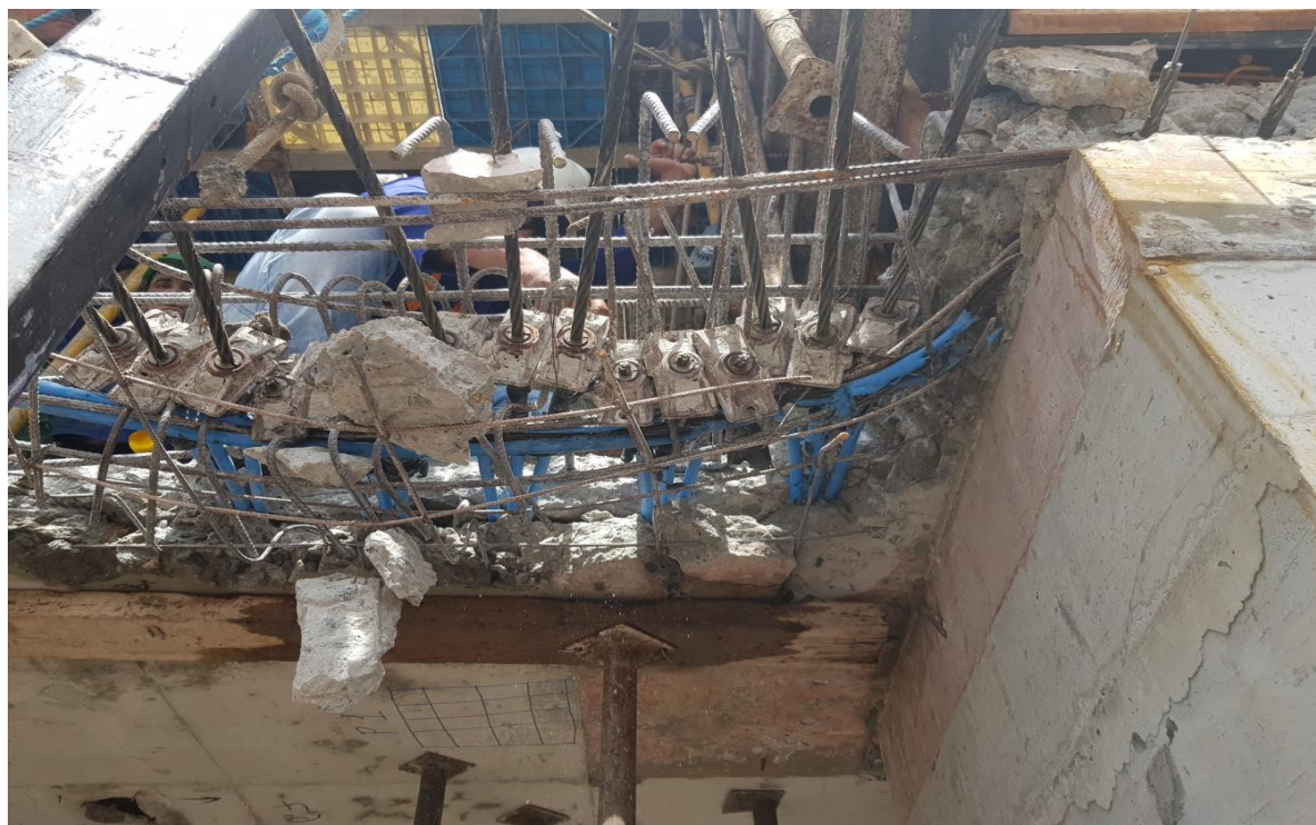
Figura 22 – Vista inferior frontal da situação da laje após rompimento da faixa de cabos não aderentes
