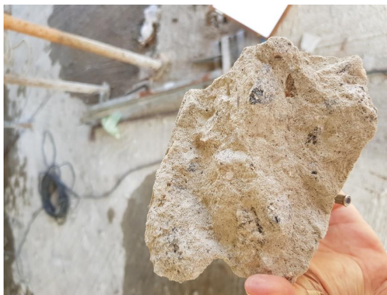
Figura 23 – Bloco de concreto expelido pelo rompimento da cordoalha
