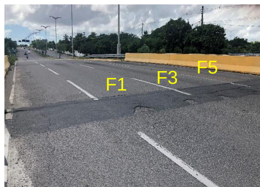
Degrau no encontro do pavimento com a obra de arte especial (final)
