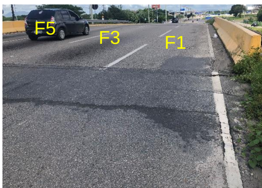
Degrau no encontro do pavimento com a obra de arte especial (início)
