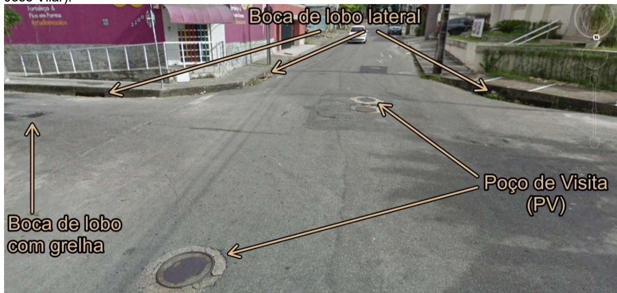
Figura 25 – Bocas de lobo e PVs da galeria principal (Cruzamento entre as ruas Bárbara de Alencar e José Vilar).
