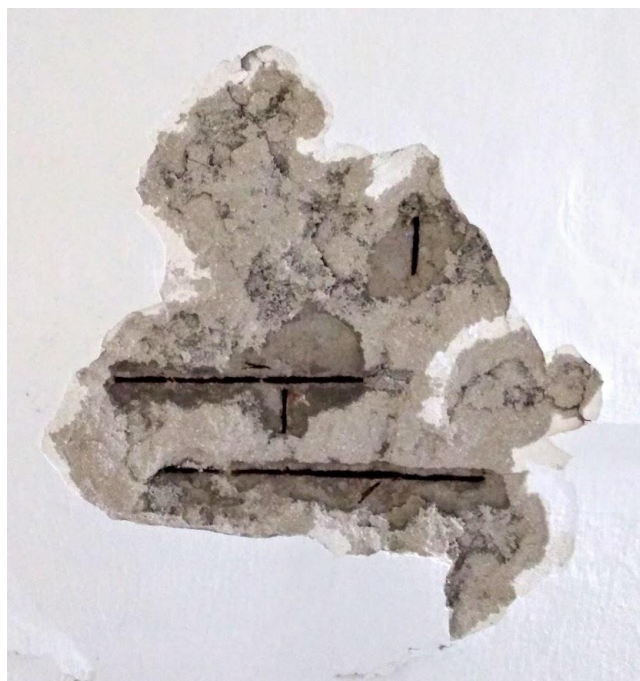
Figura 2 - Corrosão em laje
