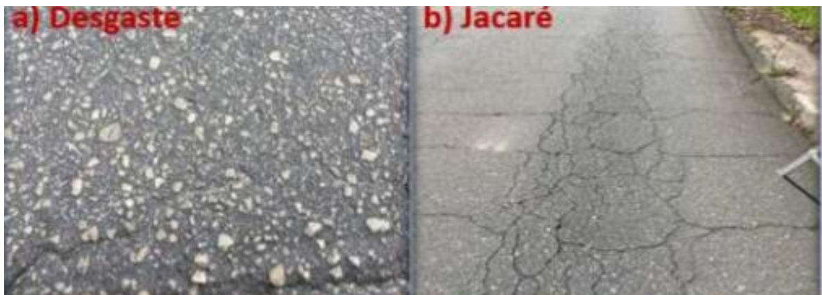
Figura 11: Exemplos de Desgaste e Trincas do Tipo Jacaré
