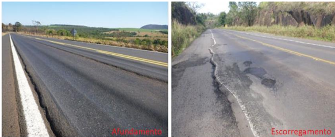
Figura 10: Exemplo de Afundamento e Escorregamento
