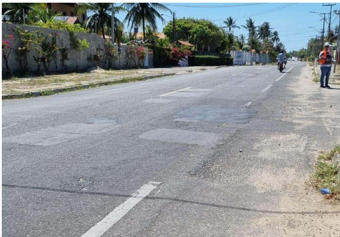
Figura 23: Foto da seção 9 com ênfase em remendos
