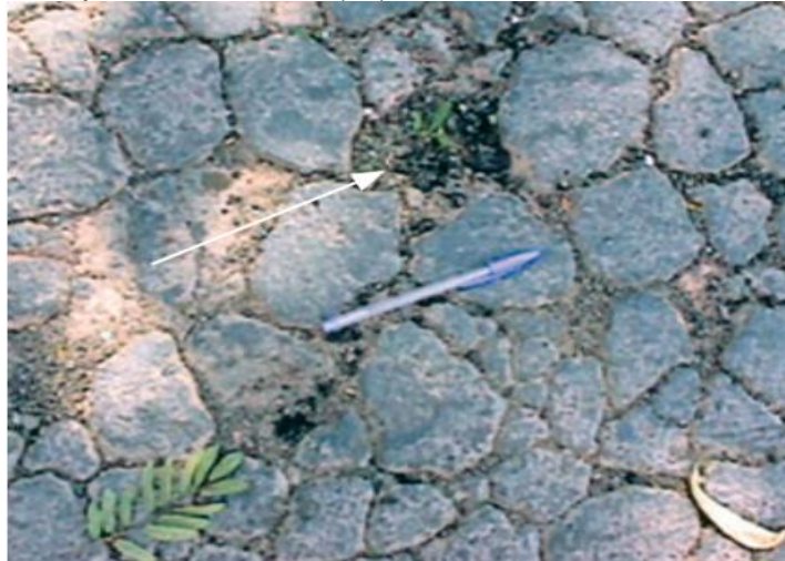
Figura 7 – Trinca couro de jacaré com erosão (JE)
