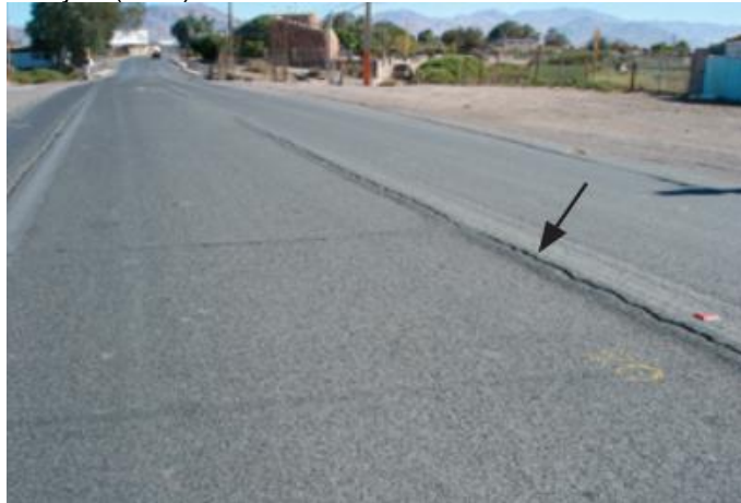
Figura 3 – Trinca de Retração (TRR)
