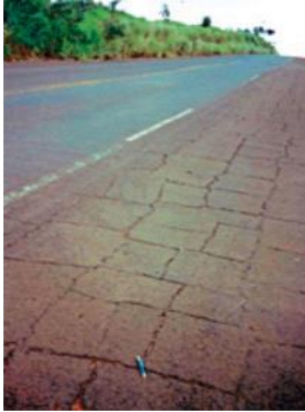
Figura 5 – Trincas de bloco com erosão (TBE)
