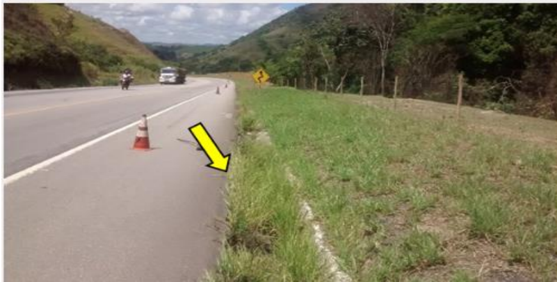
Figura 13 – Vegetação cobrindo sarjetas
