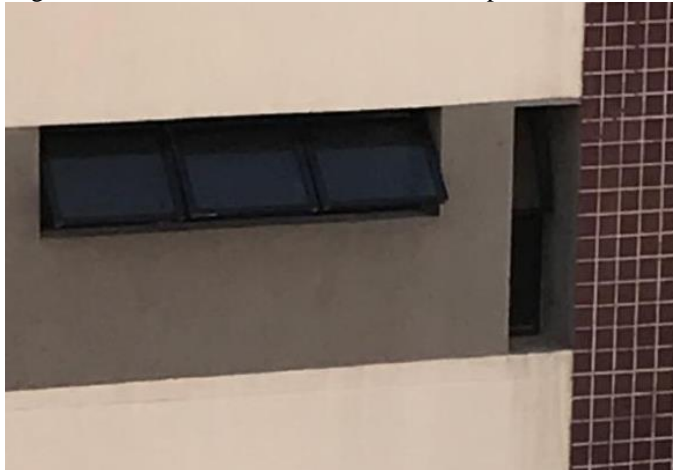
Figura 1 – Fachada revestida de tinta látex e pastilhas cerâmicas.
