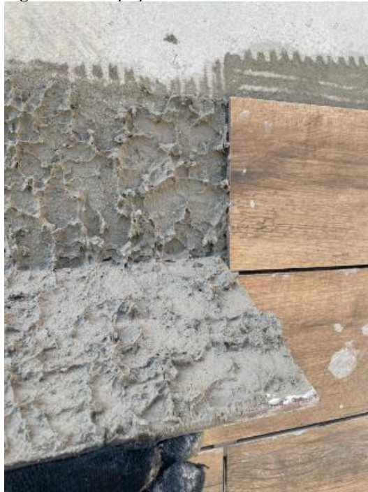
Figura 35 – Inspeção do tardo na fachada.
