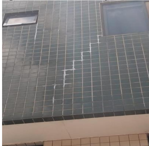
Figura 14 – Eflorescência nos rejunte da fachada.
