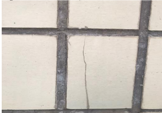
Figura 16 – Trinca em revestimentos cerâmicos.
