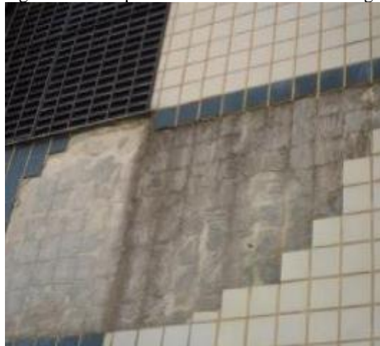
Figura 15 – Deslocamento da cerâmica com argamassa colante.
