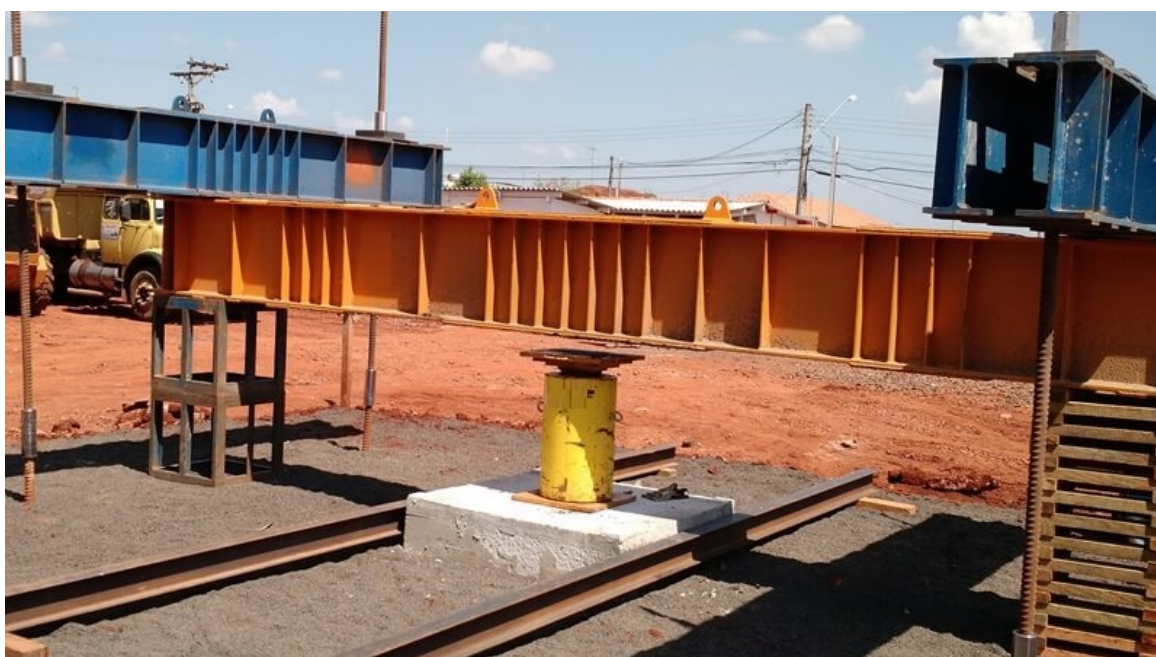
Figura 9 - Sistema de prova de carga à compressão com tirantes montado em obra
