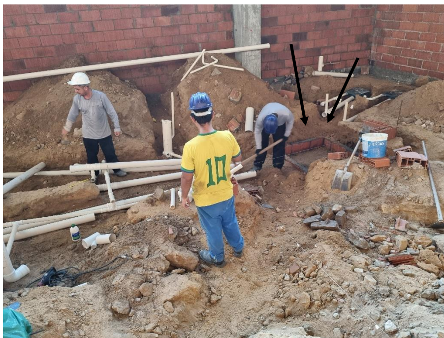
Figura 18 – Caixa de inspeção 80x80cm.
