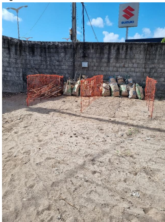
Figura 28 – Baias de resíduos.
