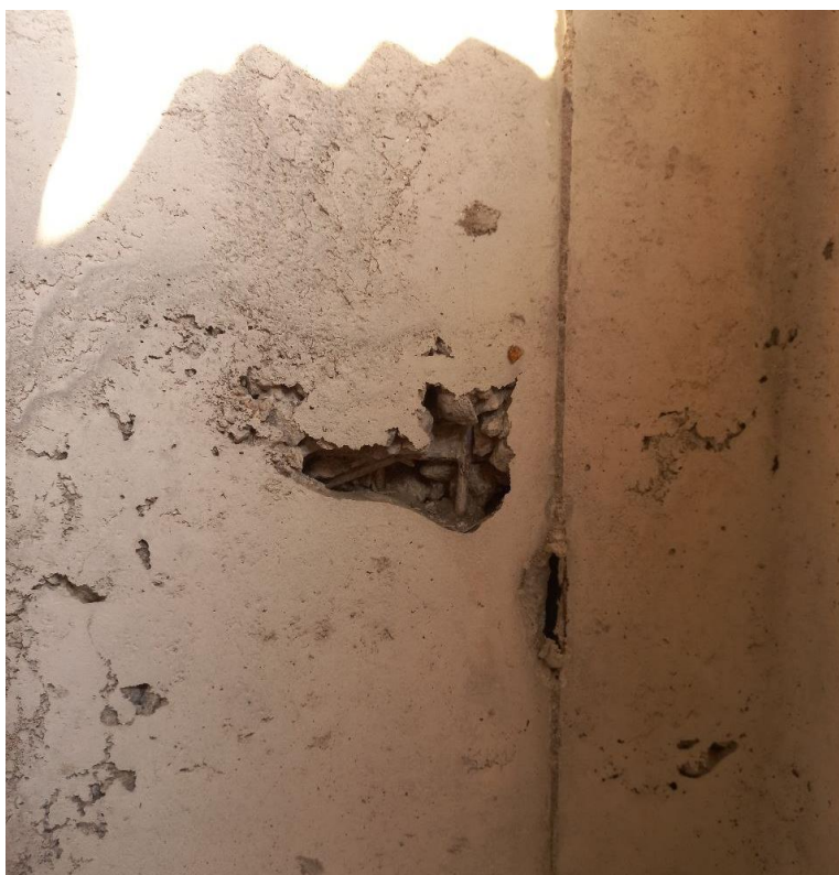
Figura 66 - Registro fotográfico da parede de concreto superfluido com nicho de concretagem expondo a armadura – Usina B
