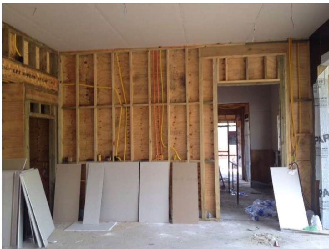
Figura 26 – Passagem das instalações elétricas no sistema wood frame.
